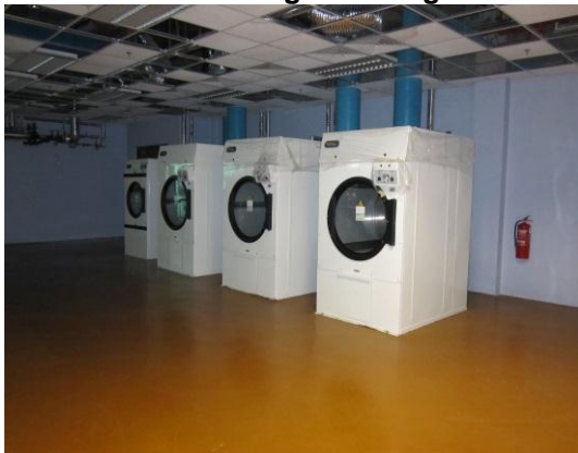
Gambar 6.9 Mesin Basuh Yang Tidak Digunakan
