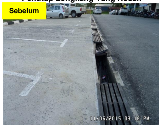
Gambar 4.10 Penutup Longkang Yang Rosak
