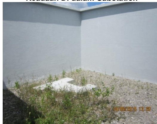
Gambar 1.11 Keadaan Di dalam Substation
