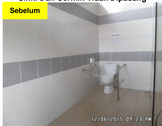
Gambar 4.7 Sinki Dan Cermin Tidak Dipasang
