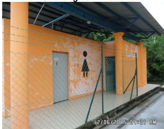
Gambar 4.6 Cat Yang Telah Pudar
