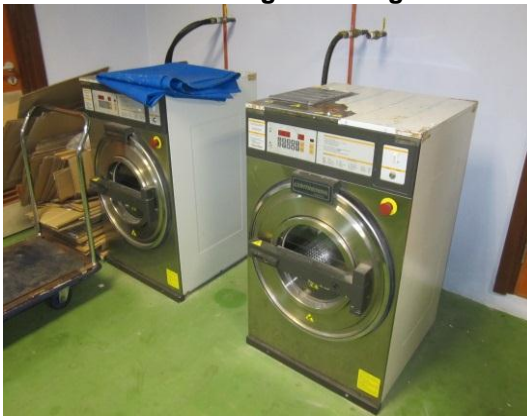
Gambar 6.10 Mesin Basuh Yang Tidak Digunakan
