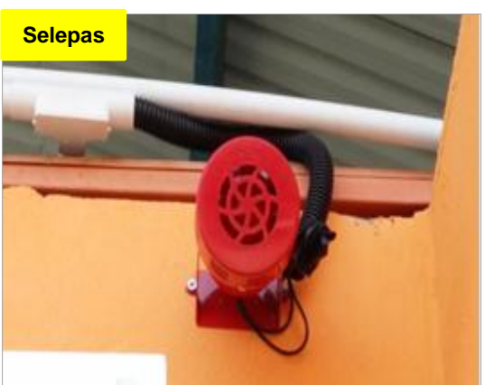
Gambar 4.9 Sistem Penggera Telah Dipasang
