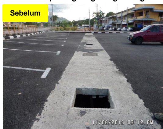
Gambar 4.12 Penutup Longkang Yang Hilang
