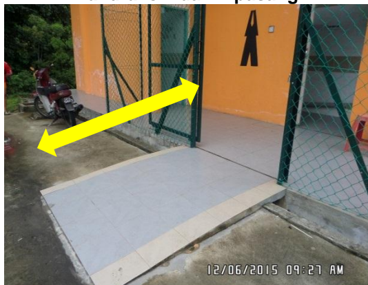
Gambar 4.5 Handrails Tidak Dipasang
